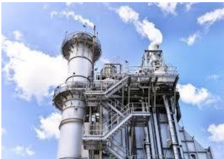
Figura V.3 Centrală modernă cu ciclu combinat cu turbină cu gaze
